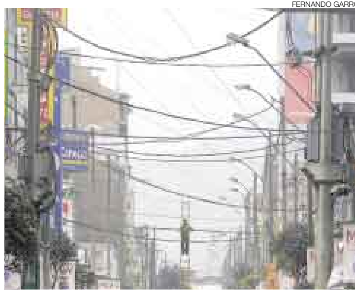
TELARAÑA. Los cables eléctricos y de telefonía entre los edificios eran un peligro constante. Ayer unos obreros hacían labores para reducirlos.
