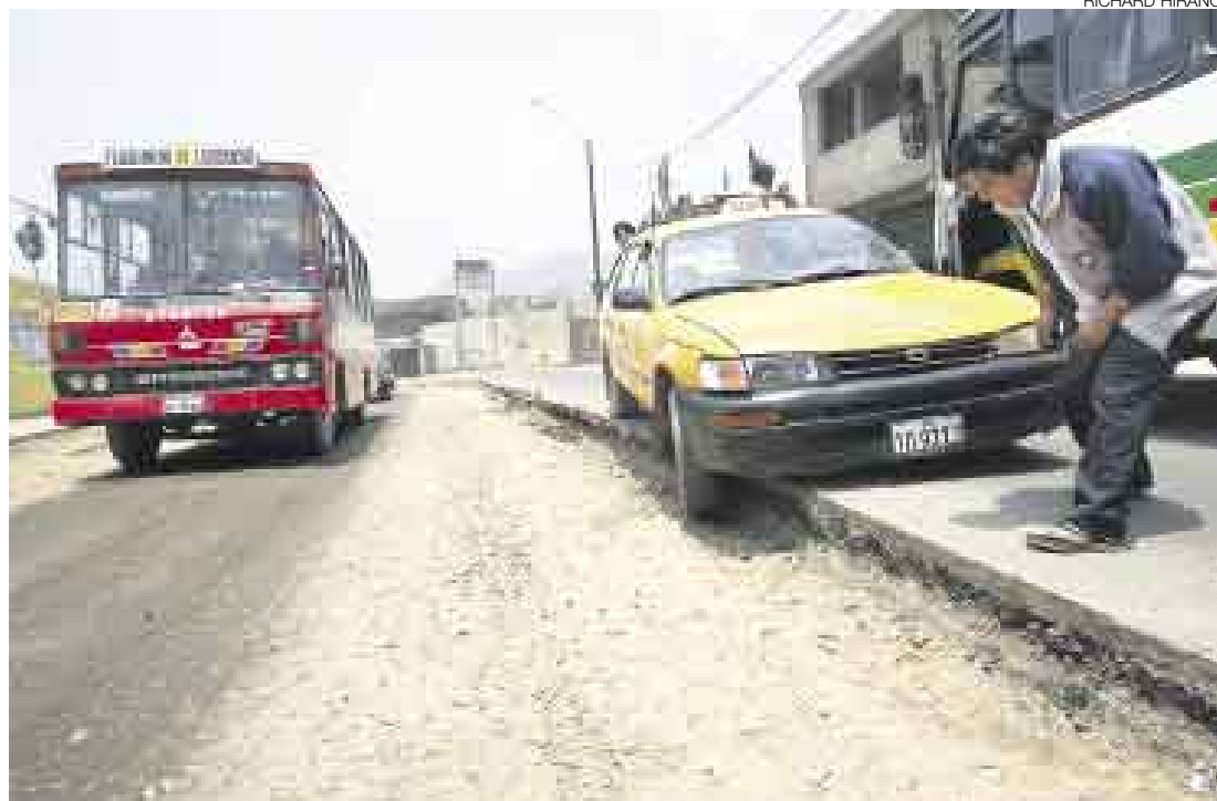
DE RIESGO. La zanja se ha convertido en un serio peligro para muchos conductores en la avenida Las Torres. En su afán de ganar tiempo muchos se meten al carril contrario y luego caen a la zanja, como ocurrió con este taxista.
