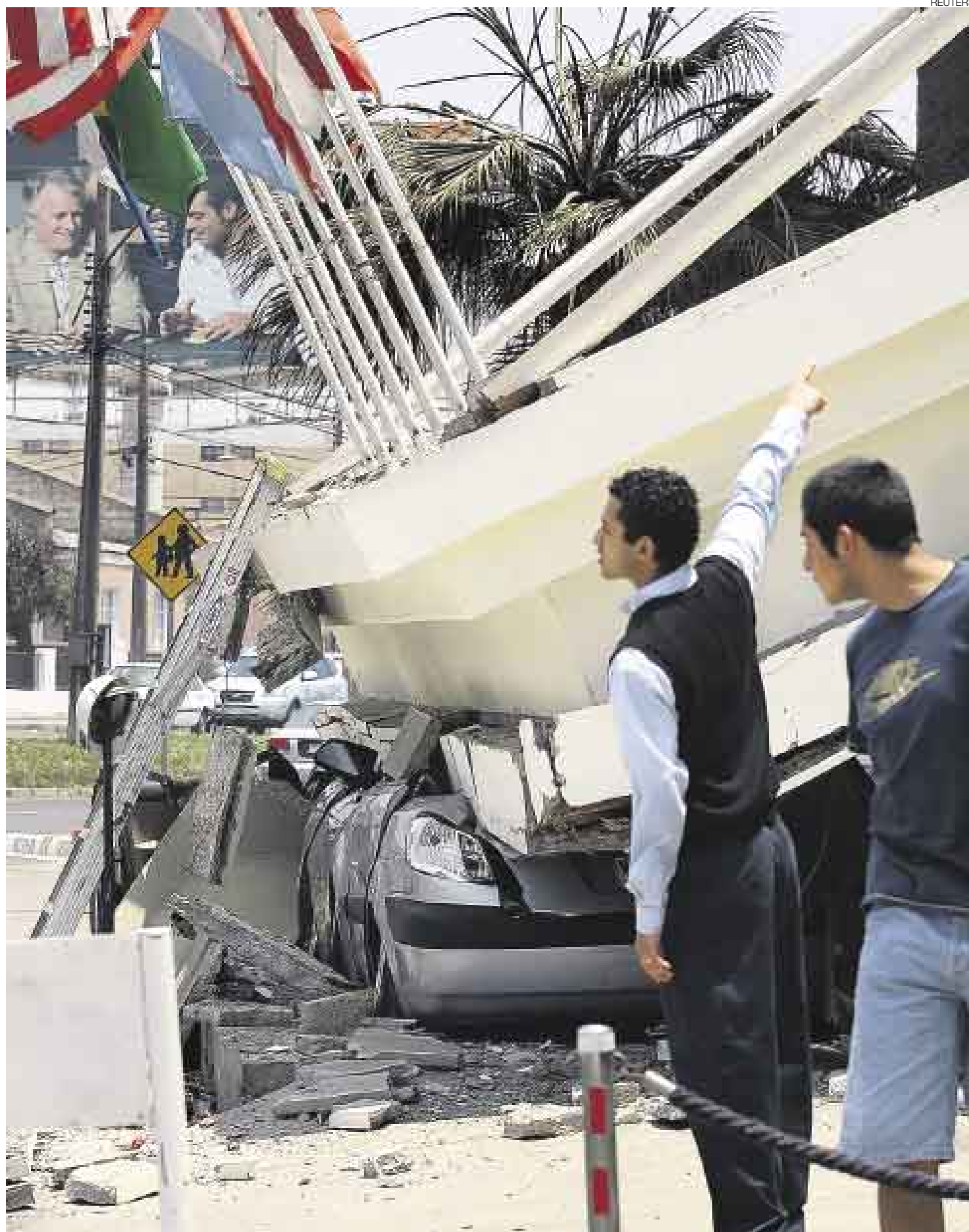
DESTROZOS. El sismo afectó edificaciones en Antofagasta y también vehículos que resultaron totalmente dañados por el derrumbe de muros.
