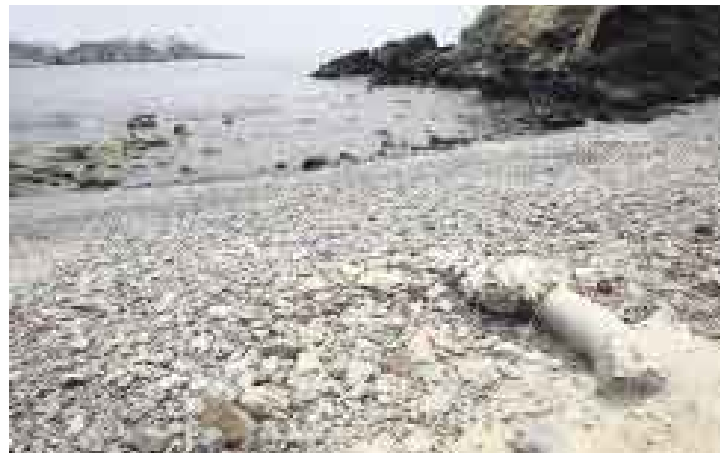
AGUAS SIN TRATAR. En varios balnearios del sur, como San Bartolo y Punta Hermosa, las tuberías y bombas de agua residual van directo al mar.
