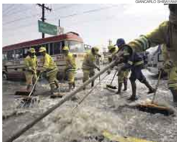
ARDUA LABOR. Personal de Emape evacuó con escobas y motobombas gran parte del agua que afectó viviendas y la Panamericana Norte.
