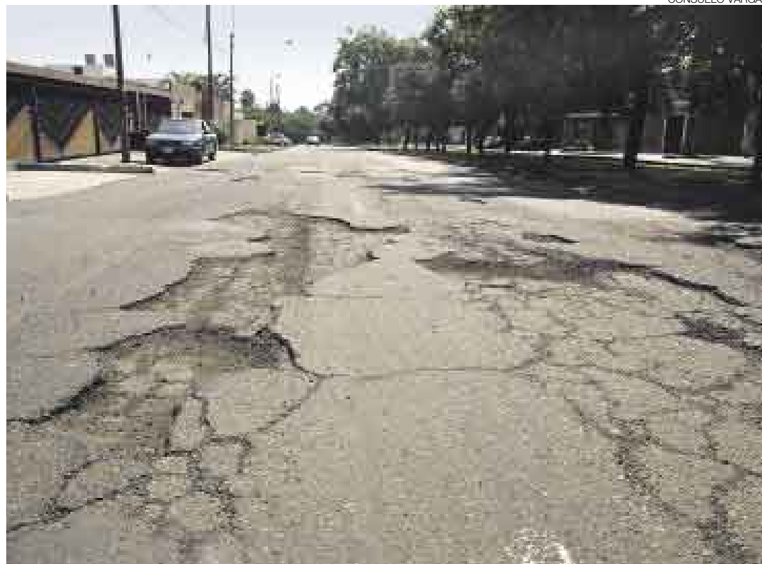
GOLPES QUE NO AVISAN. Desde hace varios meses, estos huecos en la segunda cuadra de la avenida La Fontana son un dolor de cabeza para los conductores que circulan diariamente por esta zona de La Molina.
