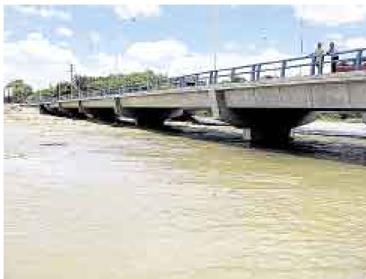
AL TOPE. Como en los años 1983 y 1998, el caudal del río Piura alcanzó ayer niveles muy altos, como se aprecia en el puente Andrés A. Cáceres.
