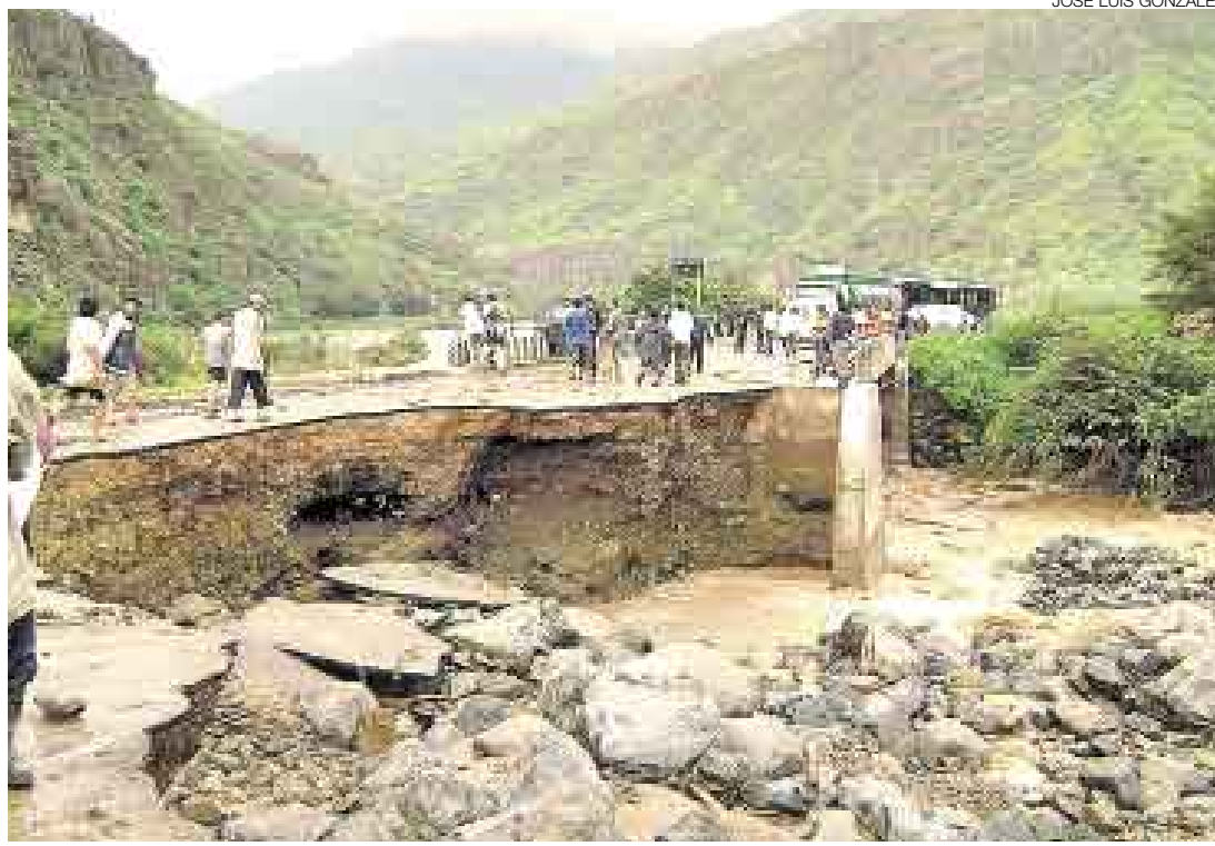
INCOMUNICADOS. Como consecuencia de las lluvias y derrumbes, Cajamarca se encuentra aislada de la costa.
