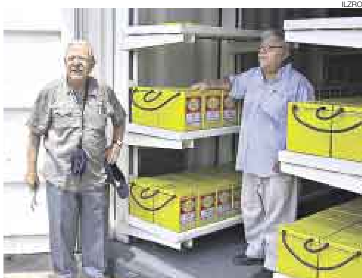
BATERÍAS. Numerosas baterías permiten almacenar la energía solar capturada por los paneles solares que se instalaron en Padre Cocha.
