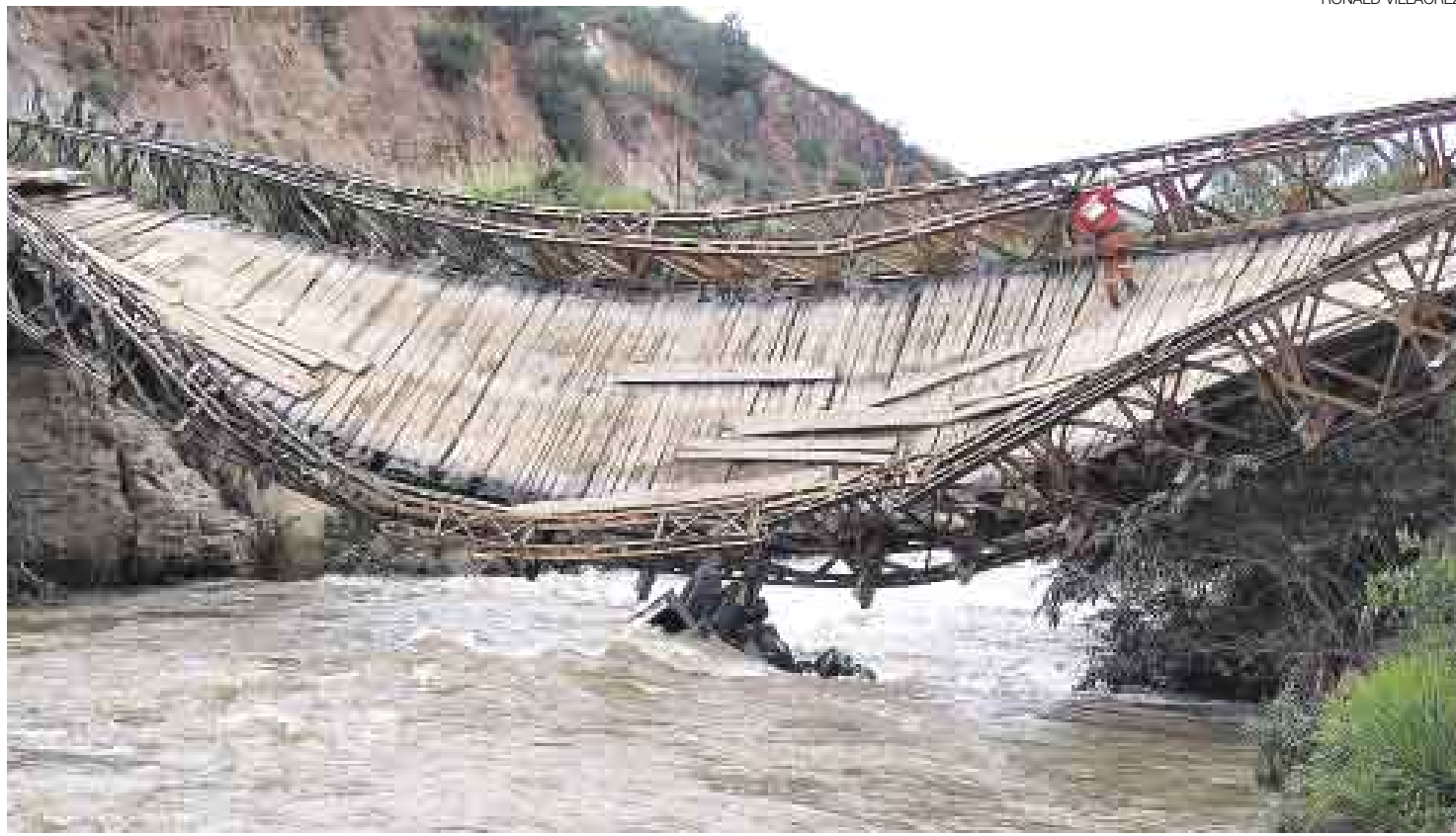
DESTRUCCIÓN. El puente Caclic, en la provincia de Luya (Amazonas), quedó destruido. Diez distritos y unas 50.000 personas quedaron aislados.
