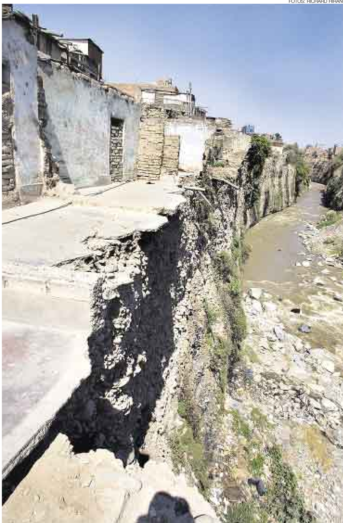
EN PICADA. La margen izquierda del acantilado del río Rímac, en la zona comprendida entre el Puente del Ejército y el límite con el Callao, es –según Defensa Civil– la zona de más alto riesgo en dicha ribera.
