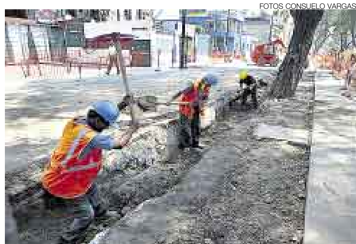
CAVAN ZANJAS. Los obreros destruyeron ayer las acequias que regaban los típicos árboles de la avenida Arequipa entre las cuadras 12 y 22.
