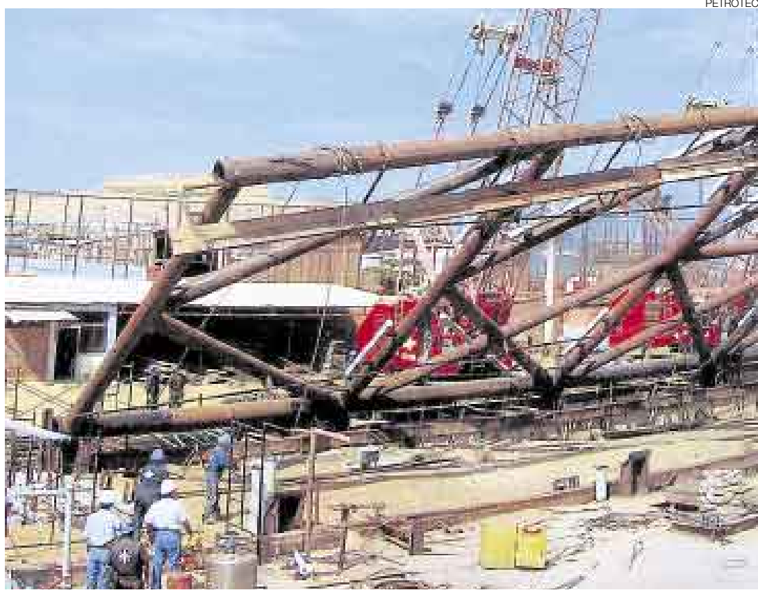
AVANZA LA OBRA. Ingenieros especialistas de Petrotech dirigen en Talara la construcción de la primera torre de extracción de crudo que se colocará en el mar, frente a Lambayeque.
