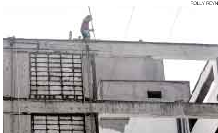
DE RIESGO. Un pintor camina sobre una viga en el piso 8 de una edificación de la avenida Ricardo Palma, en Miraflores, sin contar con arnés de seguridad.
