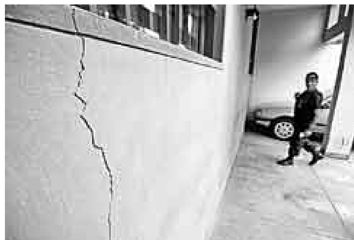
DAÑADA. J J Ingenieros ha construido un edificio en la cuadra 3 de la calle Del Llano Zapata. El inmueble contiguo también presenta rajaduras.
