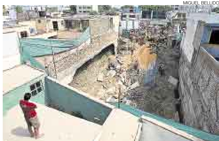
SIN BASE SÓLIDA. Ingeniero se indigna ante malas calzaduras y responsabilidades no asumidas por las autoridades (ver: Tras el derrumbe).
