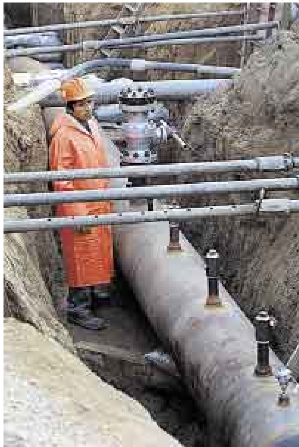
GAS AL SUR. ENERGY TRANSFER TAMBIÉN QUIERE CONSTRUIR UN DUCTO QUE RECORRA LA CORDILLERA.
