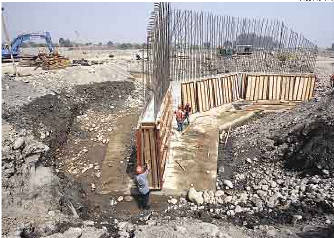
AVANCE. Personal del MTC construye las bases de los tres pilares del puente metálico Santa Rosa, que unirá la vía Carapongo y la Carretera Central (a la altura del kilómetro 11), en Santa Clara, distrito de Ate-Vitarte.
