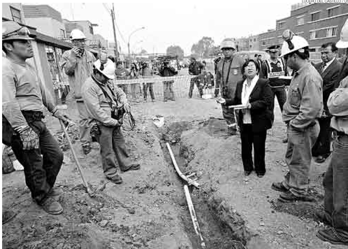
A TIEMPO. Técnicos de Cálidda controlaron el escape del gas y cambiaron la tubería de distribución. La fiscal Julita Pachas (en la foto) llegó hasta la zona.
