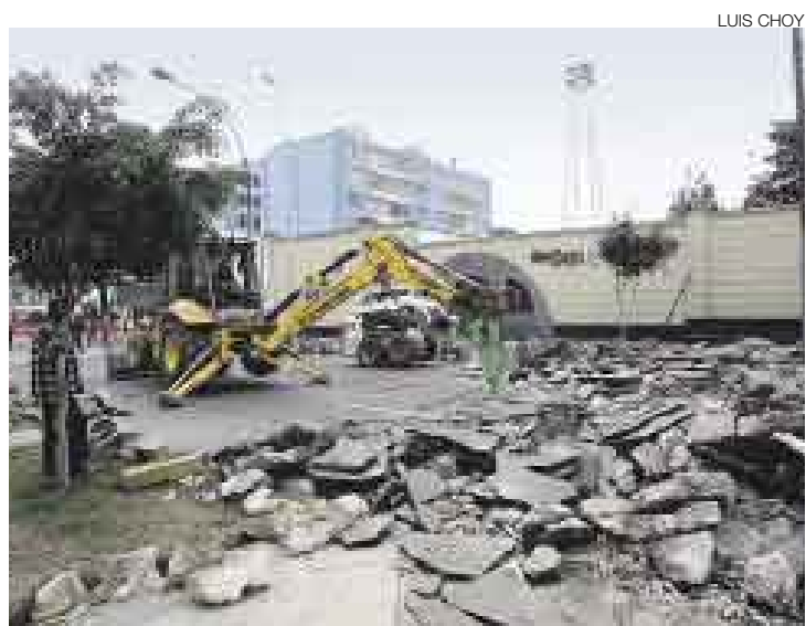
TRABAJOS. Los niños del nido Dante Alighieri, situado en la cuadra 10 de la Av. Petit Thouars, soportaron los ruidos causados por las obras en dicha vía.
