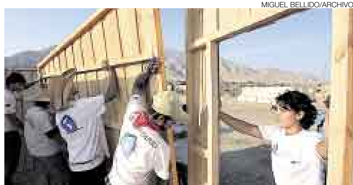
NO BASTA. Los voluntarios hacen lo que pueden, pero el Estado debe miles de viviendas para los damnificados (ver: Faltan techos).
