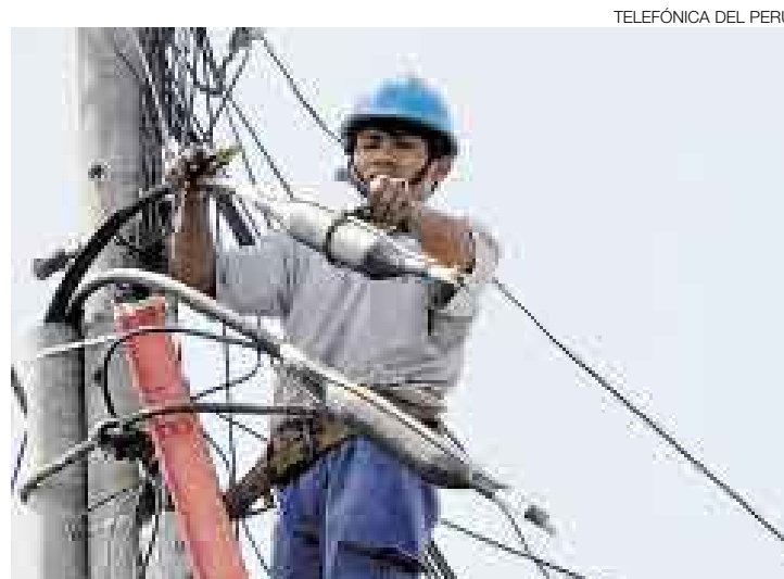
A REPARAR. Los robos en Lima equivalen al 70% del total nacional. Telefónica se encarga de reponer los cables para no afectar a sus clientes.
