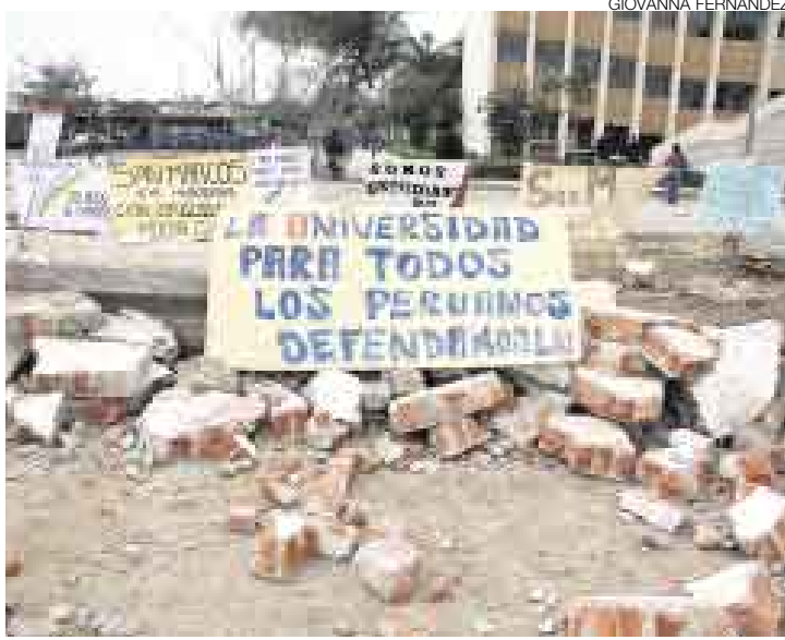
ESCOMBROS. Según los representantes de la universidad, el Concejo de Lima destruyó su cerco perimétrico sin coordinaciones previas.
