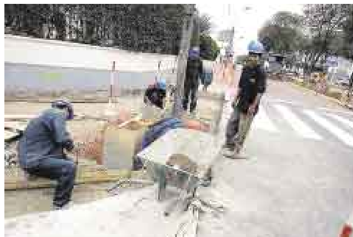
DETALLES. En la avenida Arequipa operarios dan los toques y acabados finales a las veredas que también han sido remozadas al igual que la calzada.
