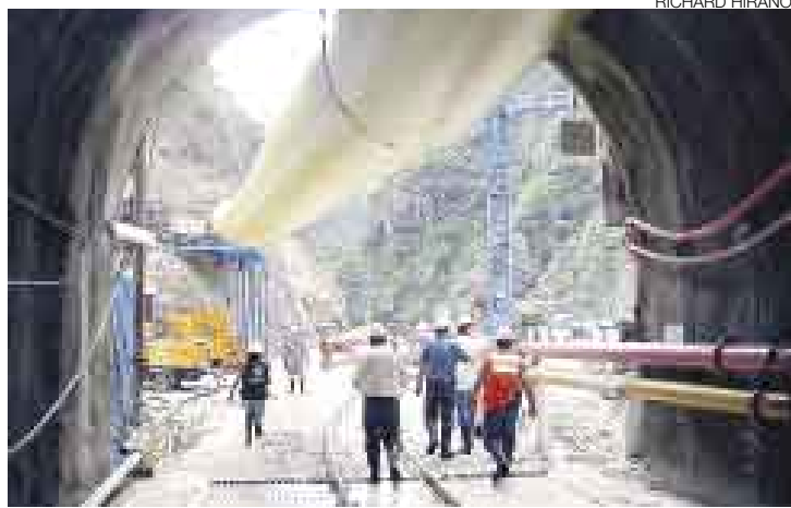
CAMPAMENTO OCCIDENTE. Con los huaicos de marzo, el barro cubrió las obras hasta donde llega la manga de aire acondicionado.
