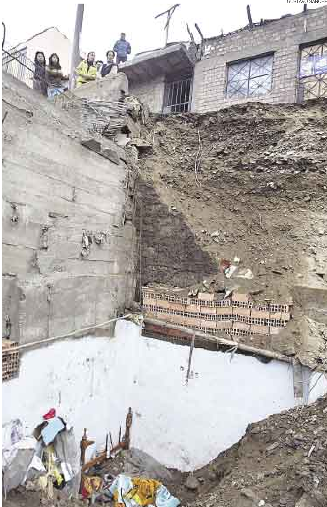
ARTESANAL. El muro que se desprendió ayer de este cerro fue construido con ladrillos hace veinte años.
