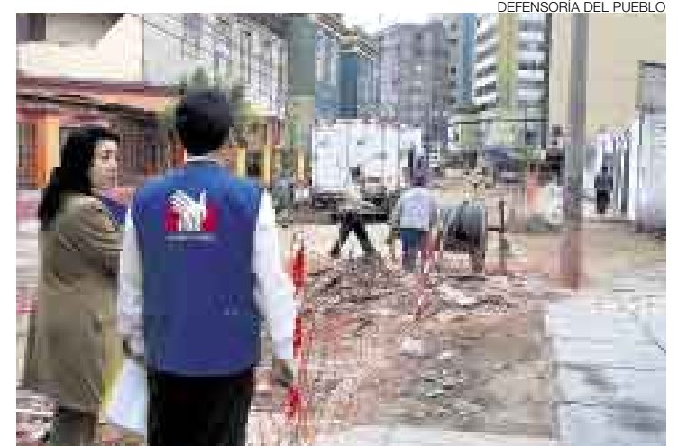
LENTA. La rehabilitación de la calle Berlín avanza a paso de tortuga. Sin embargo, el plazo indefectible de entrega de la obra es el 3 de setiembre. ■
