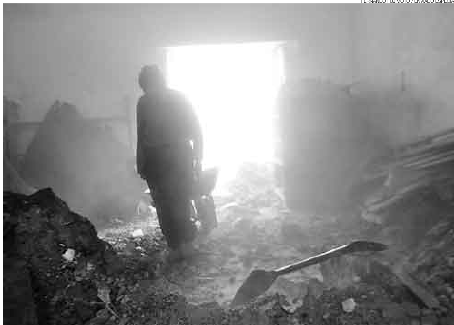
SIGUE EL DRAMA. Las heridas no cierran. Los escombros y lo mucho por reconstruir recuerdan que Pisco todavía espera un nuevo futuro.
