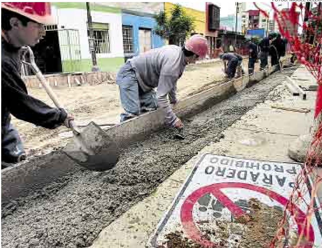
JORNADA. Aunque ayer se apreciaron más obreros y maquinaria, la obra no finalizará el próximo 3 de setiembre.
