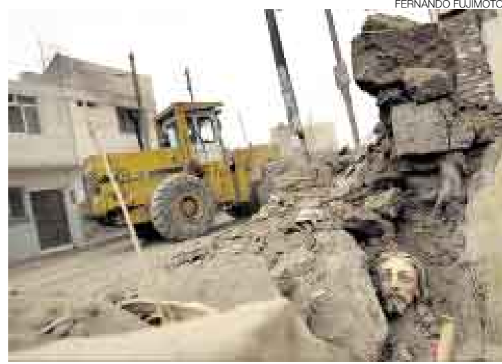
TODAVÍA ESCOMBROS. Lectores reclaman un Forsur menos burocrático y más ejecutor para acelerar la reconstrucción del sur chico.
