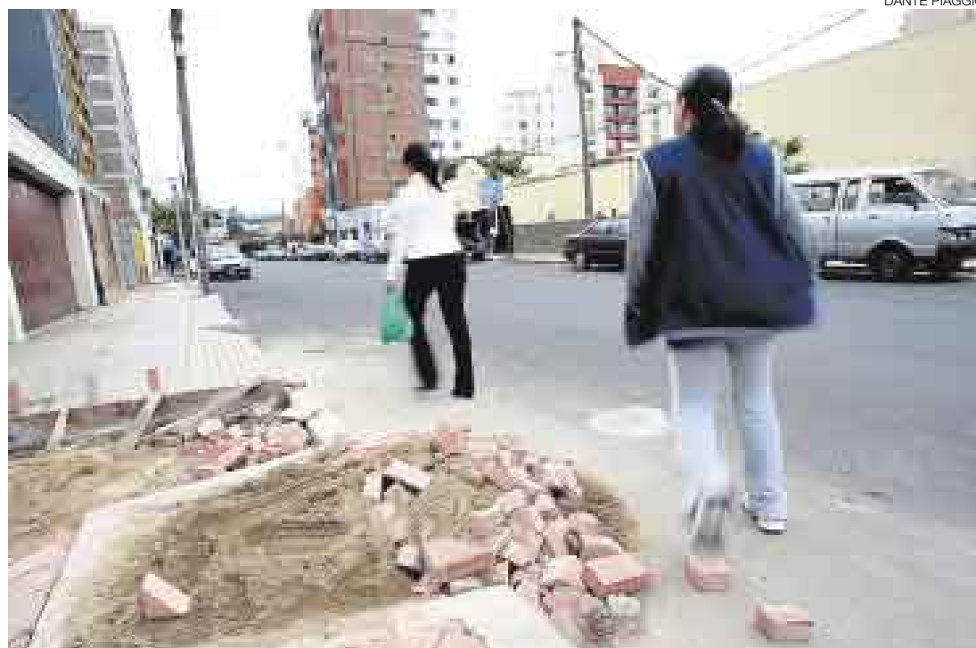
MOLESTIAS. Los trabajos en la calle Berlín no tienen cuándo terminar. Las veredas son una muestra de ello.
