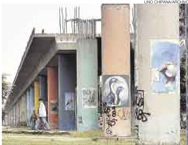
ACTIVOS. Las instalaciones del tren eléctrico de Lima se deterioran por la escasez de recursos para darle mantenimiento, asegura la AATE.
