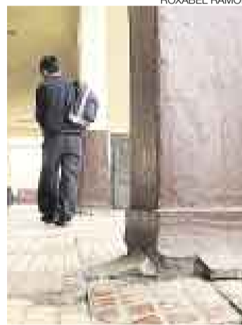
GRAVE. Hay evidente daño en las columnas del Bartolomé Herrera.
