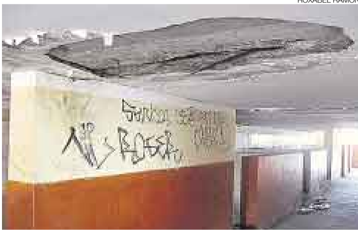
CLAUSURADO. Varios ambientes del colegio Mariano Melgar han sido cerrados a causa de los daños causados por las filtraciones de agua.
