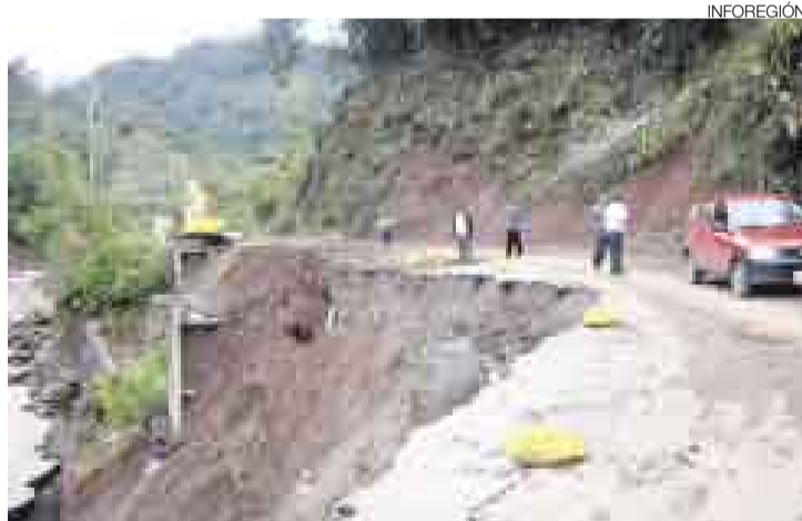
INCLEMENTES. Las lluvias dejaron incomunicado al departamento de Ucayali por algunas horas. La Chancadora fue el sector más afectado.
